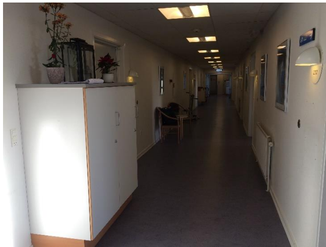
Foto 1 Blok B, 3. sal. Skab / møblering i flugtvejsgang.
