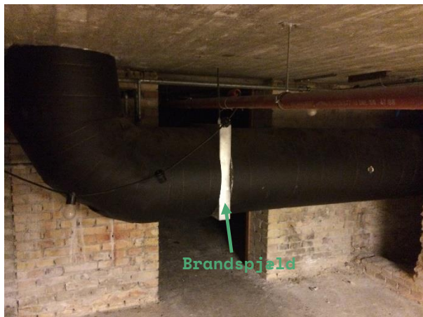
Blok B, krybekælder. Brandspjæld i ventilationskanal.
