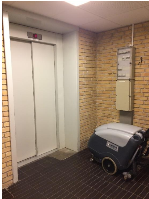
Foto 29 Blok B, Gangareal i stueetage. Opladning af gulvvaskemaskine ved dør til elevatorskakt.
